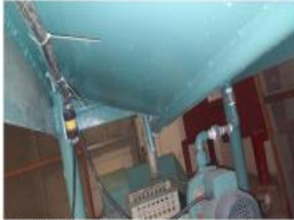
Vista Inferior Hacia Bomba 2
