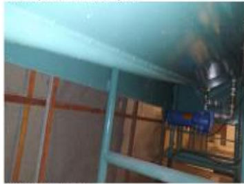
Vista hacia Bomba 1
